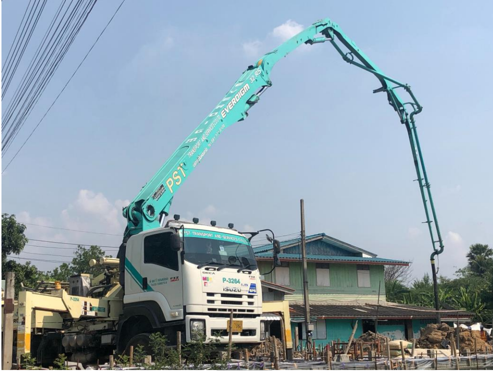
การก่อสร้างโครงสร้างบ้านพักอาศัย โดยใช้รถป้อนกริตในการลำเลียงและเทคอนกรีต
